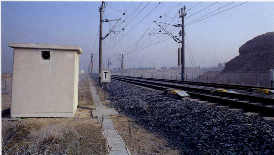
TRANSICION DE CATENARIAS
