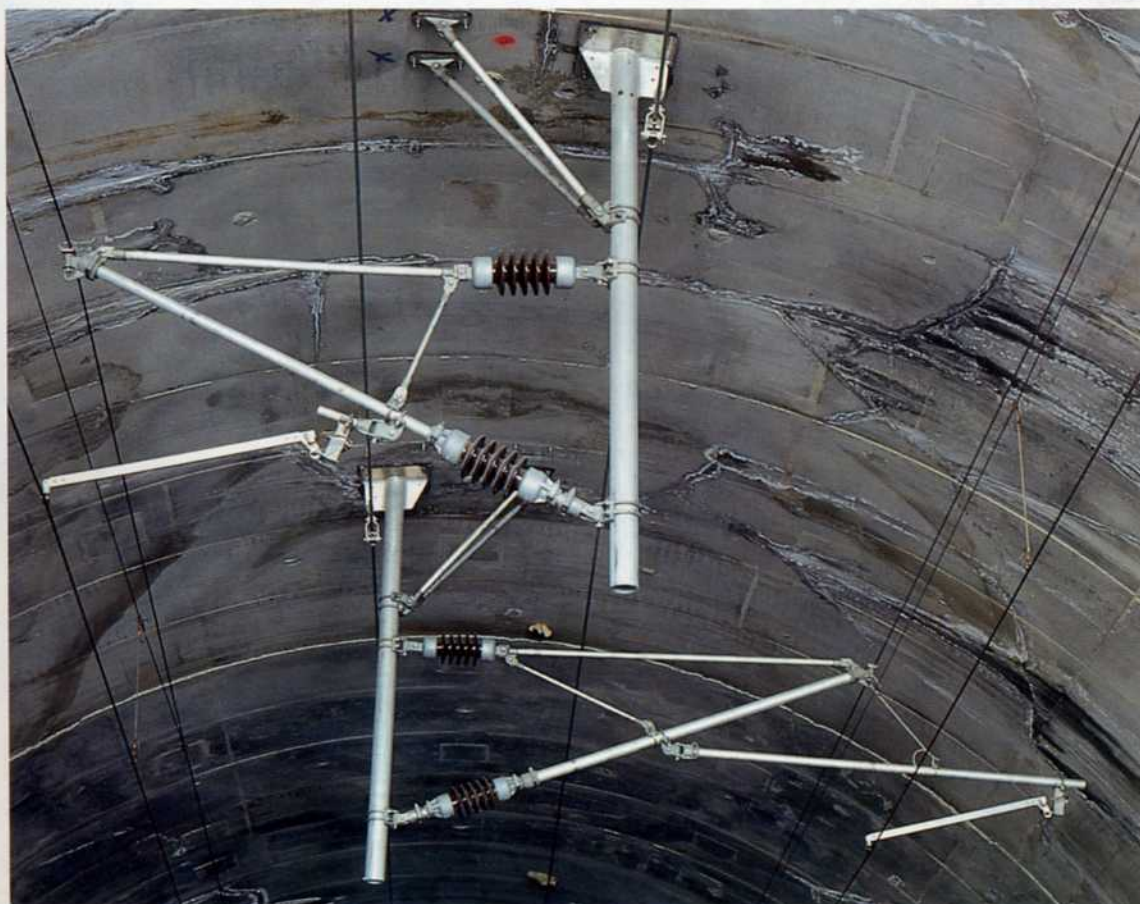
SOPORTE DE CATENARIA EN TUNEL
